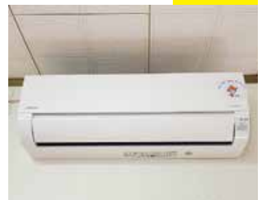
▲矢楯会館に整備されたエアコン
