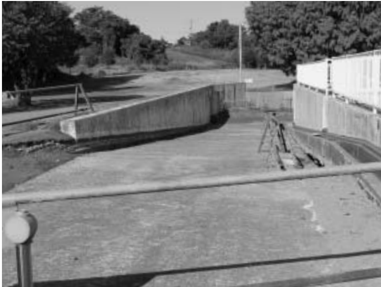
地盤沈下した連絡通路
