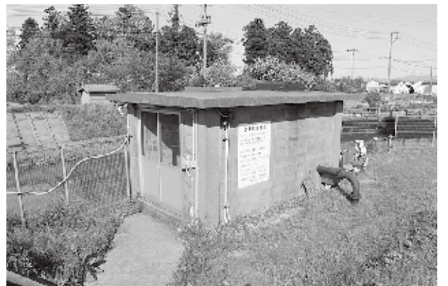
ブロック積で耐震性能の無い取水ポンプ室 (弥彦村)
