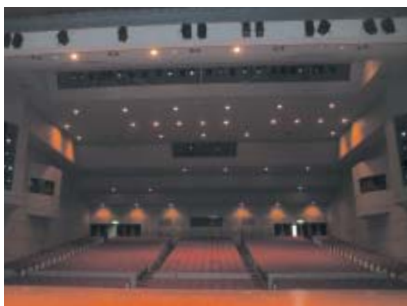
脱落危険の恐れのある「大ホール」天井
