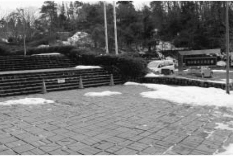
補修が必要な文化会館階段
