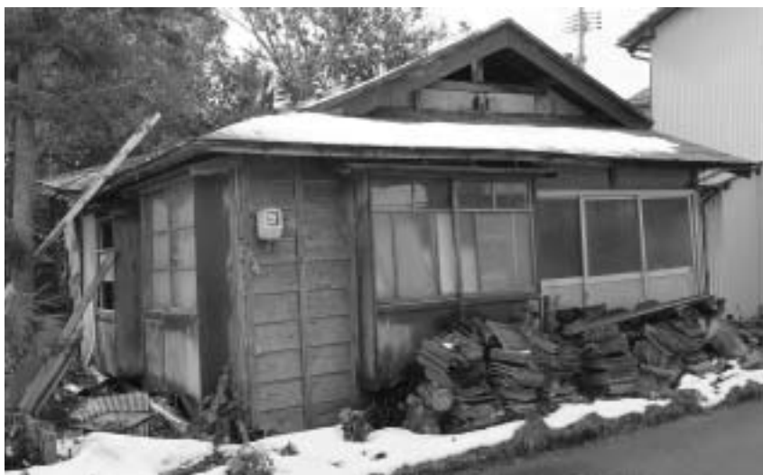
危険な空き家
