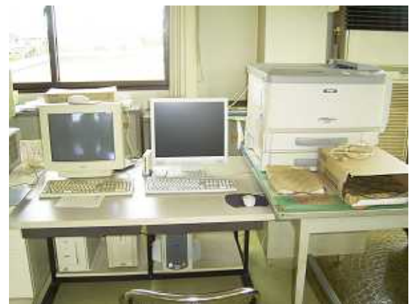
監視室計装機器
