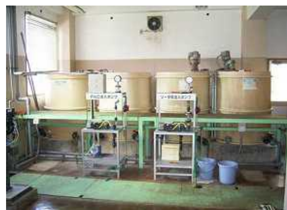
管理棟内部薬注ポンプ
