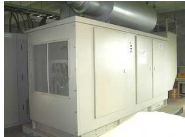
非常用発電機
