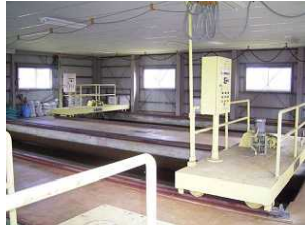
急速ろ過池内部
