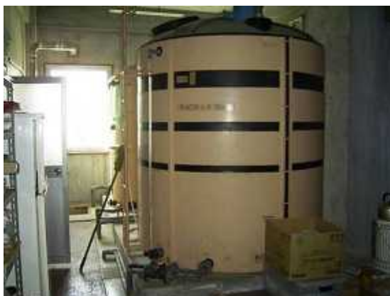
管理棟内部薬液タンク
