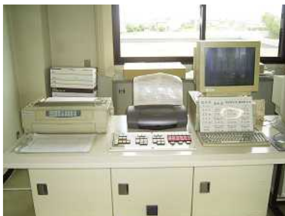
監視室計装機器
