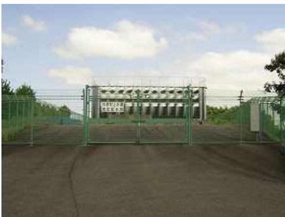
低区ステンレス配水池正面
