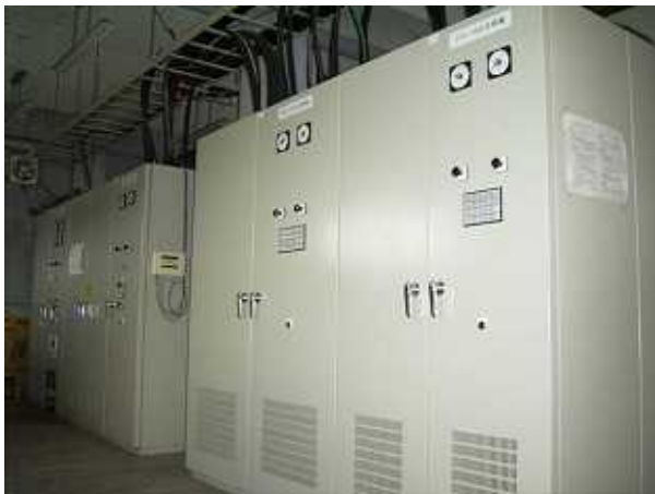
電気室内部計装盤
