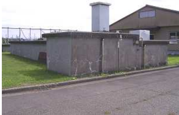
着水井フロック形成池全景
