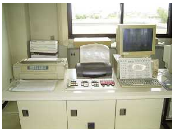
監視室計装機器
