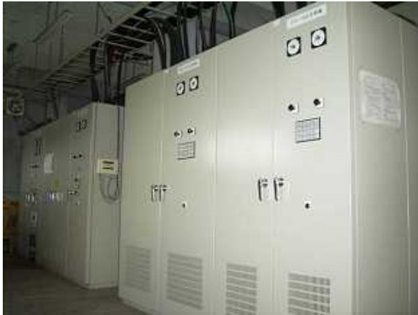
電気室内部計装盤
