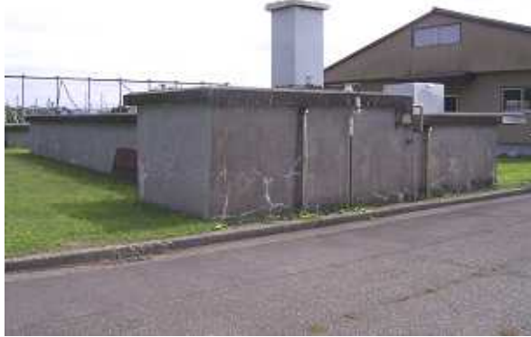
着水井フロック形成池全景
