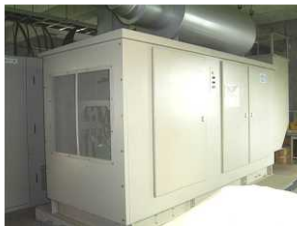
非常用発電機
